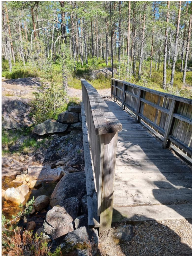
Bru ved startpunktet er i dårlig stand
